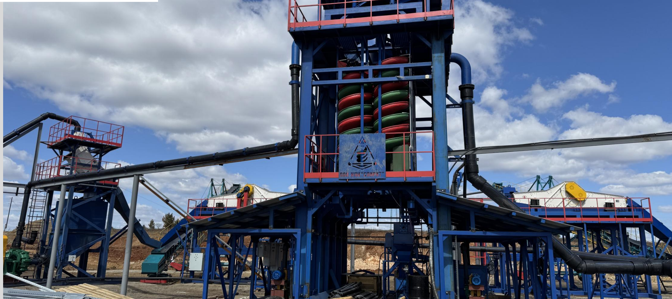
Сезонная фабрика по переработке лежалых хвостов углеобогащения ООО Разрез Черемховуголь (группа Эн+)
