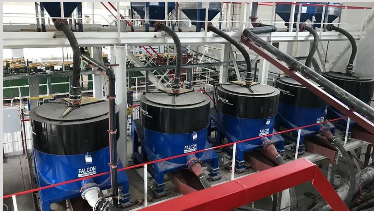
Гравитационная установка переработки оловосодержащих хвостов обогащительной фабрики Хинганолово
